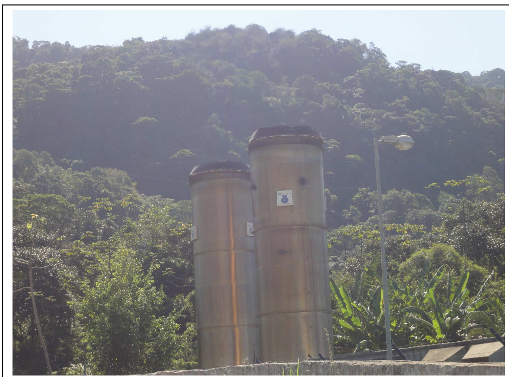
Figura 22 Queima de gases em flare no aterro sanitário da Terrestre Ambiental
