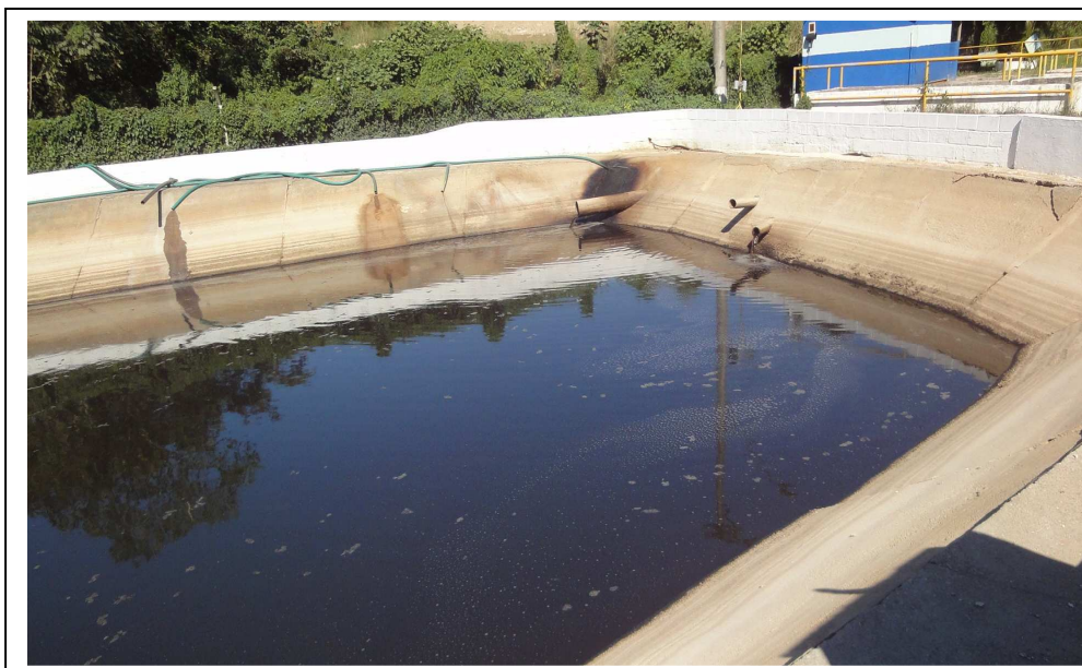
Figura 18 Tanques de armazenamento de chorume
